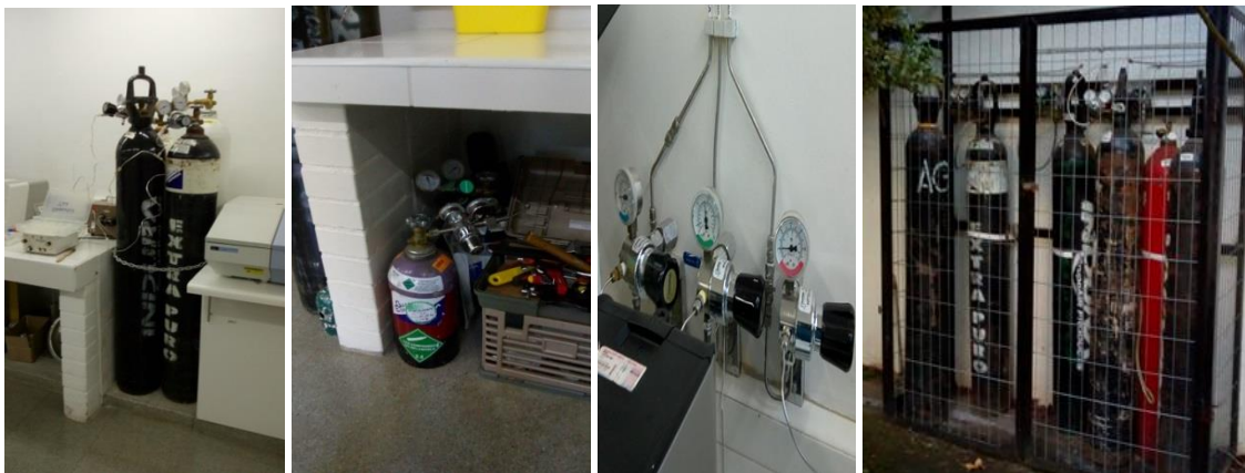
Cilindros de gases portatiles y sistemas de conexión desde el exterior hacia laboratorios.
